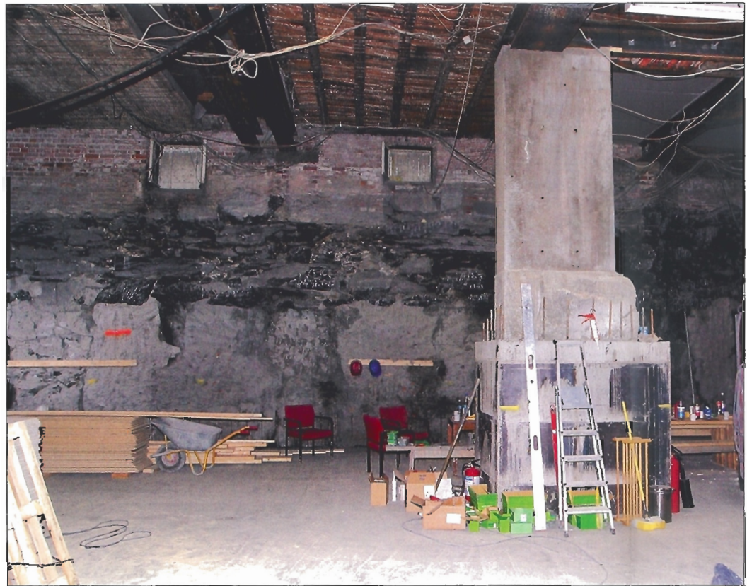
KJELLERETASJE. Byggherre hadde ønsket om å utvikle byggets kjeller. Nå er det forvandlet til et stort rom med plass til to etasjer. I kjelleren kan man tydelig se hvordan jetpelene støtter under eksisterende murfundament.
