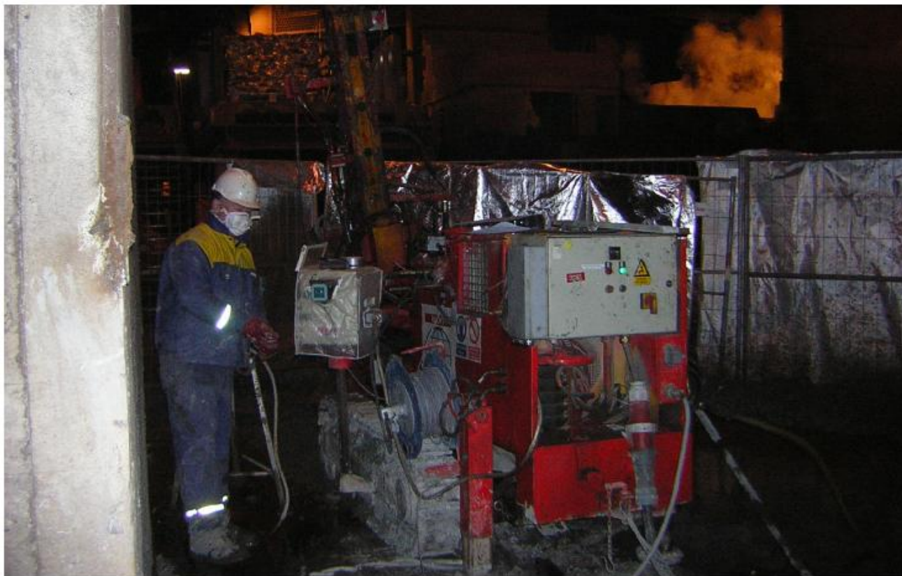
Jetpeltproduksjon inne i smelteverket. Ovnene i bakgrunnen var i full drift.
